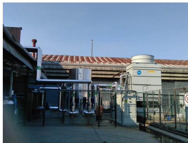
Figura 46 - Sistema de refrigeração de água industrial.
