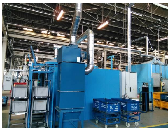
Figura 44 - Sistema de filtragem de extrações de soldadura.
